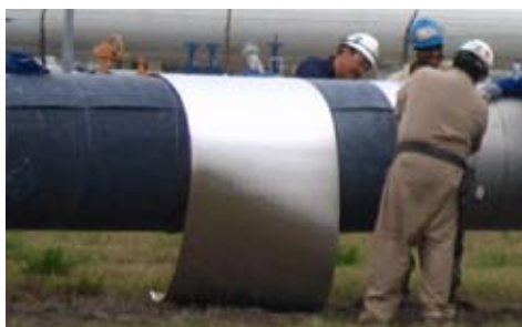
Modificações de Tubos de Vapor: A instalação simples e rápida do invólucro externo da manta aerogel de camada única pode expulsar a umidade do isolamento úmido antigo e recuperar o desempenho do sistema.
