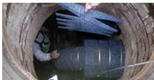
Áreas de Difícil Acesso: As mantas flexíveis de aerogel são ideais para áreas de difícil acesso e podem suportar inundações periódicas.
